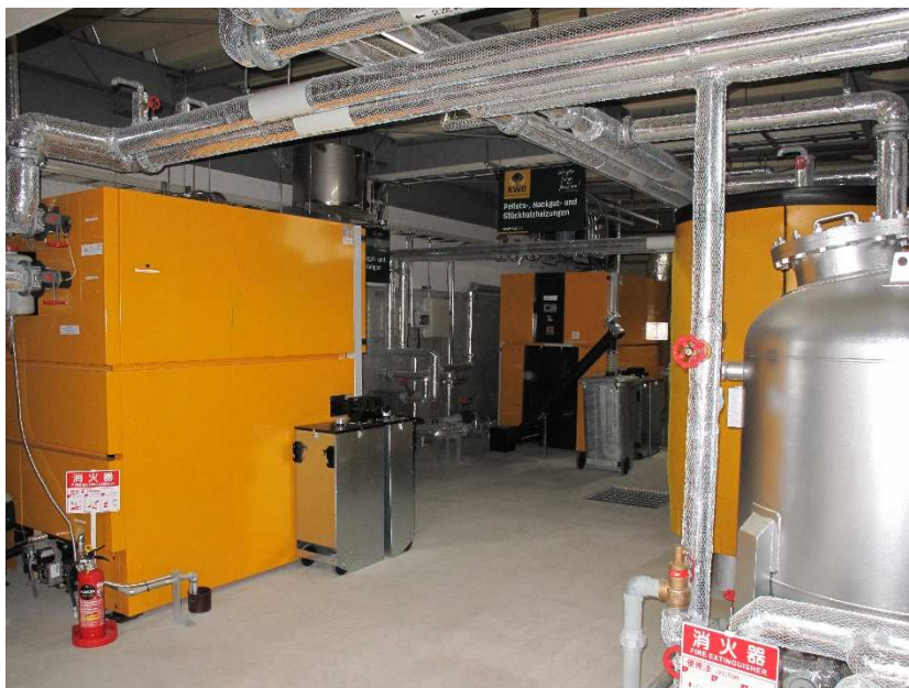
バイオマスボイラー室内全景
