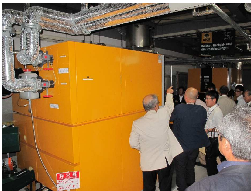
バイオマスボイラー
