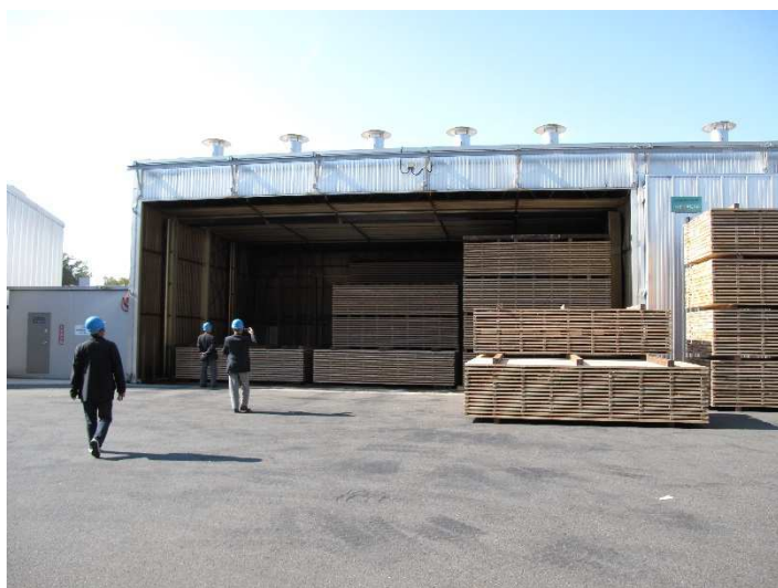
乾燥施設 自家用バイオマスボイラー（熱電併給）の廃熱を利用した木材乾燥施設
